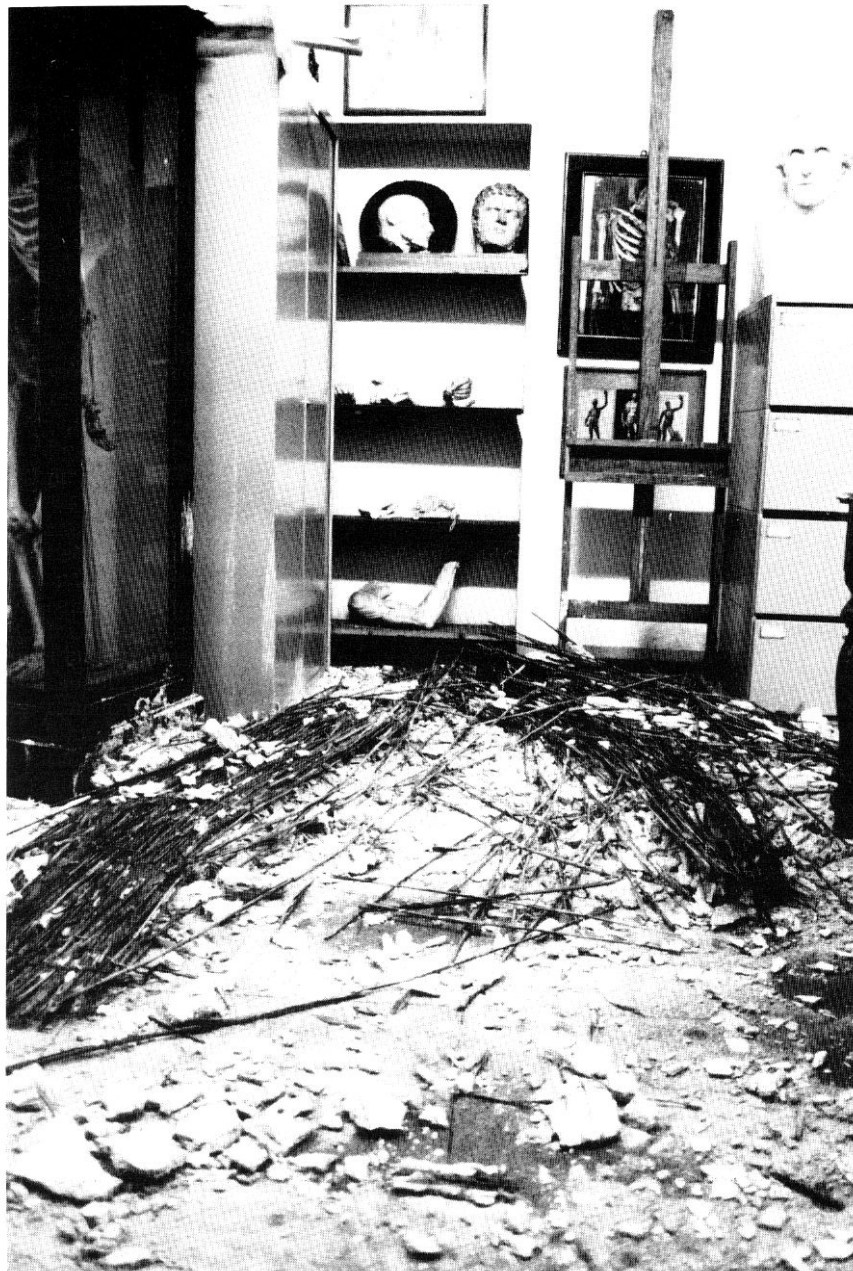
Dopo il crollo di un soffitto all'Accademia.
